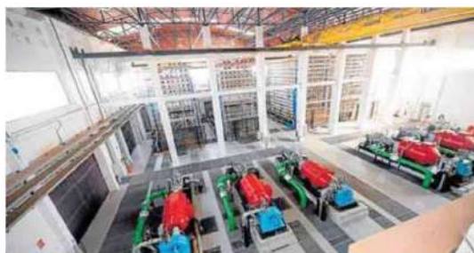
Instalaciones de la desaladora del sureste. CANARIAS7
